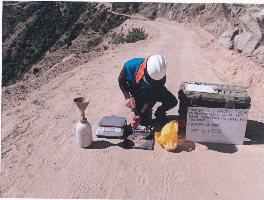
FIGURA N° 25. Ensayo de Densidad de Suelo en Campo. Progresiva 06 + 000 (Método del cono de arena).
