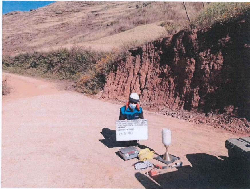
FIGURA N° 1. Ensayo de Densidad de Suelo en Campo. Progresiva 00 + 000 (Método del cono de arena).
