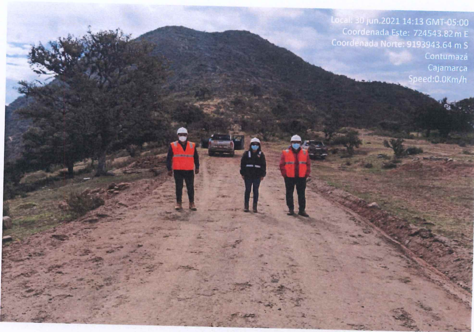
Fotografía 37. Resultado del refine y compactación del material granular para afirmado e=0.15m y verificación de los trabajos en campo por parte de la Entidad.
