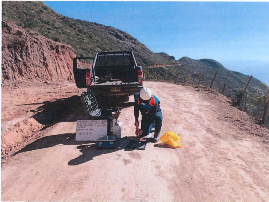
FIGURA N° 3. Ensayo de Densidad de Suelo en Campo. Progresiva 00 + 500 (Método del cono de arena).
