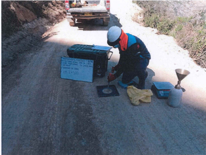
FIGURA N° 11. Ensayo de Densidad de Suelo en Campo. Progresiva 02 + 500 (Método del cono de arena).
