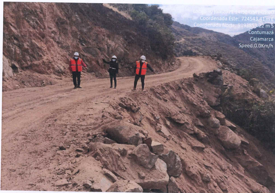
Fotografía 39. Resultado del refine y compactación del material granular para afirmado e=0.15m , resultado del ensanchamiento y verificación de los trabajos en campo por parte de la Entidad.
